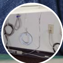
крепления для проводов
